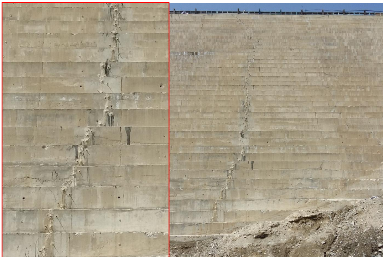
Рисунок 2. Фото тела плотины, показывающее размер трещины
